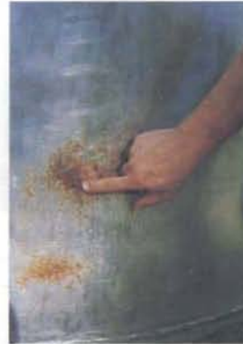
タンク側面ピンホール
