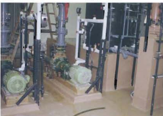
薬品ポンプ周り
